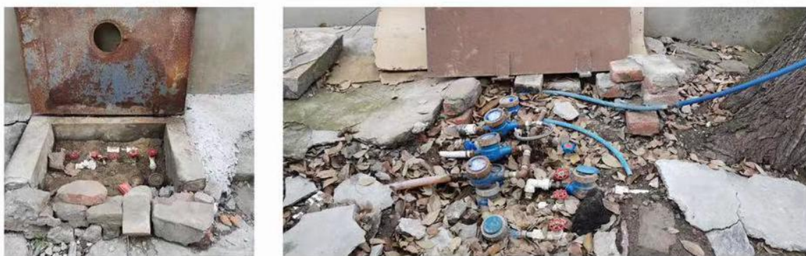
供水管道破损现状图
